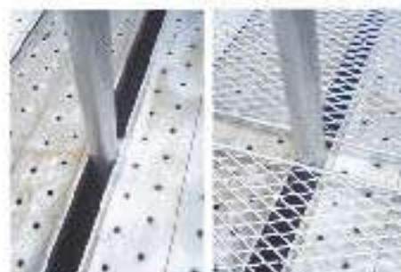
単管足場パイプ部分の隙間
