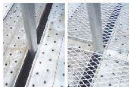
単管足場パイプ部分の隙間
